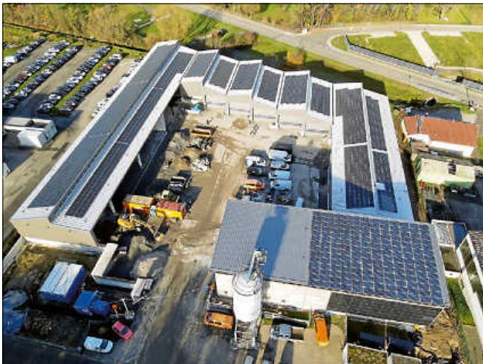
„Ganzjahresstützpunkt“: Beim kurz vor der Fertigstellung stehenden Ganzjahresstützpunkt der Enzkreis-Straßenmeisterei in Maulbronn sorgt eine große PV-Anlage mit Speicher dafür, dass der Stromverbrauch künftig aus eigener Produktion gedeckt werden kann. Das Vorzeigeprojekt wurde vom Bundesministerium für Wirtschaft und Energie gefördert.
