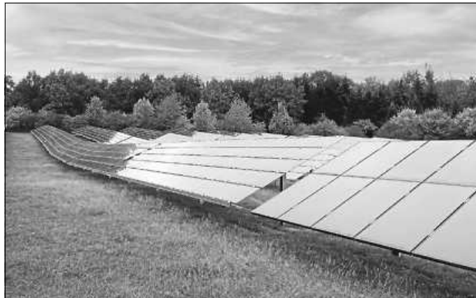
Die Radroute „Powerful in den Nordschwarzwald“ führt passend zum thematischen Schwerpunkt „Erneuerbare Energien“ am Solarpark Feldrennach vorbei. Bilder: Enzkreis
